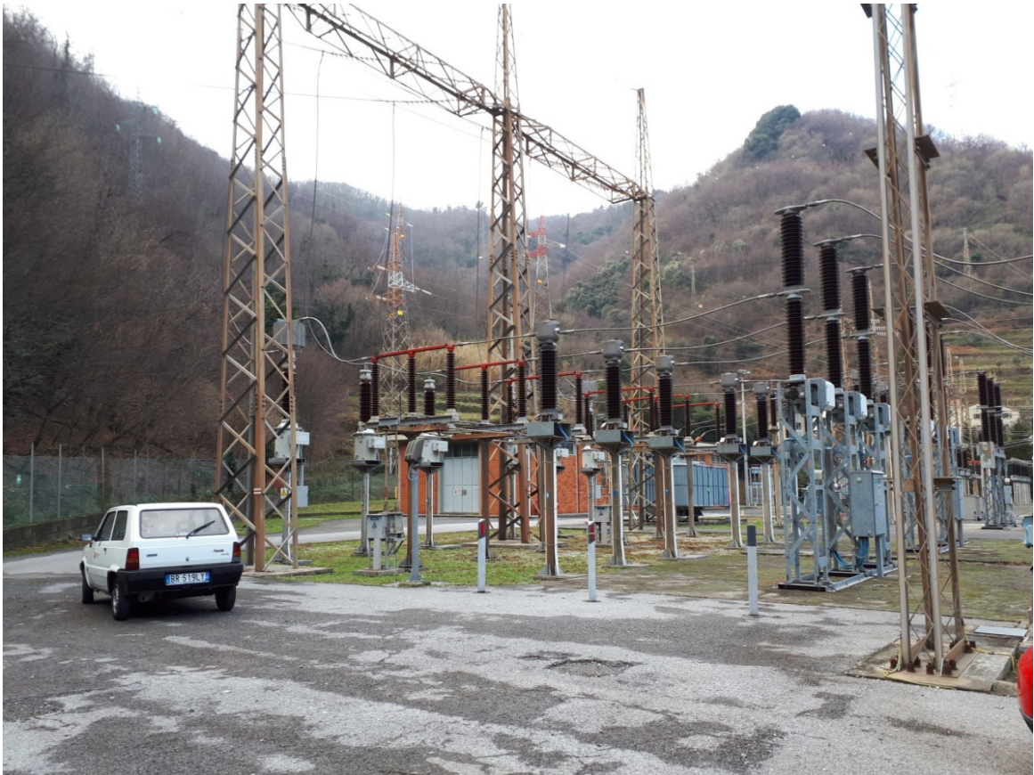
05-Area centrale E-distribuzione.
