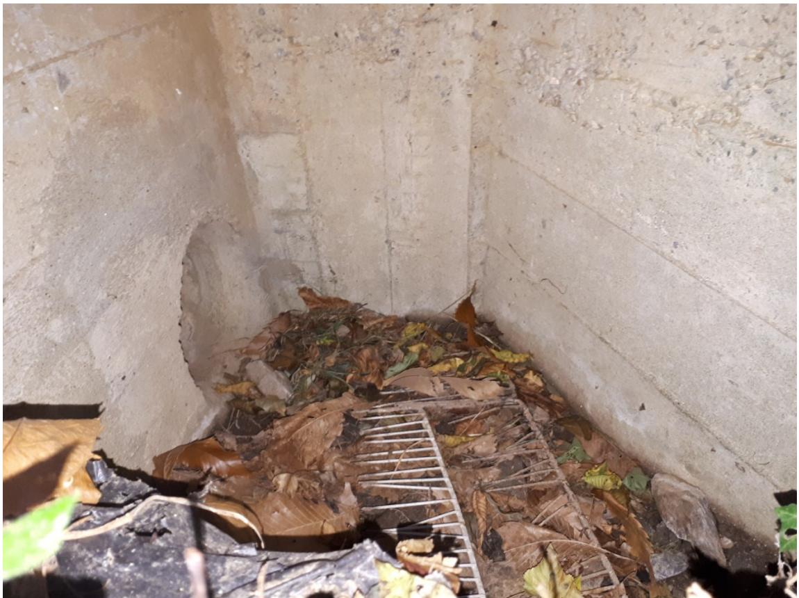
26-Interno pozzetto raccolta acque meteoriche.
